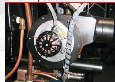
Ventilatore aspirazione fumi
