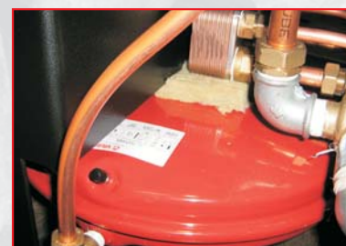
Vaso di espansione e scambiatore sanitario a piastre
