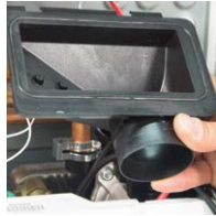
Ispezione raccolta condensa
