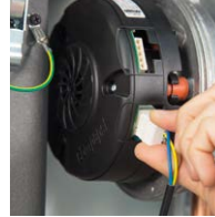
Disconnessione elettrica ventilatore
