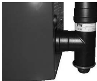
Fig. 117 - Pulizia canale da fumo
