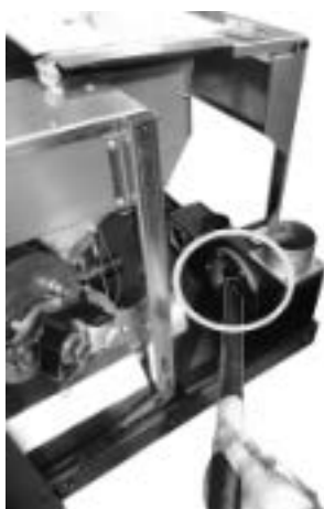
Fig. 111 - Pulizia canale da fumo
